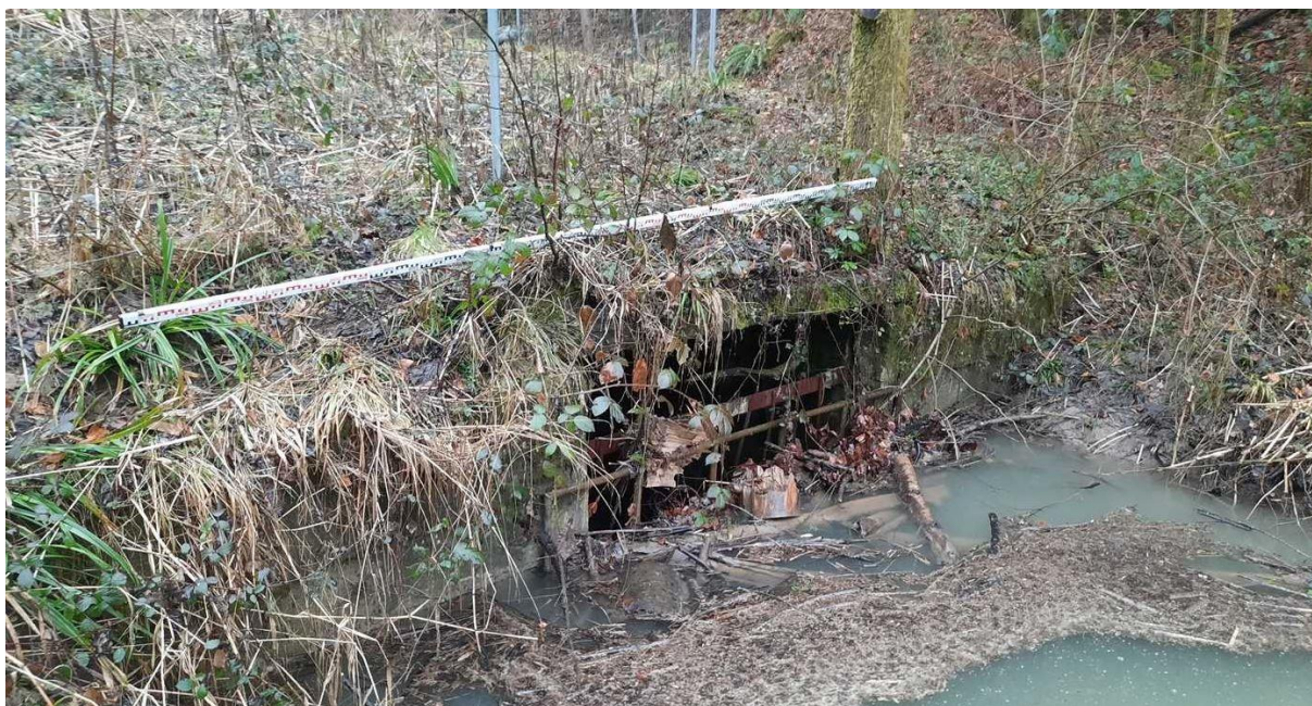
Slika 13: Prikaz obstoječega vtoka v cev, kjer je izkazan večji nanos plavlja (foto: Banovec)
