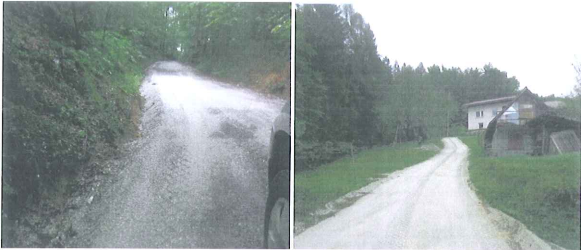
Poškodovana in sanirana cesta JP 709401 – Lupinica – Bernardovec - Ježni Vrh
