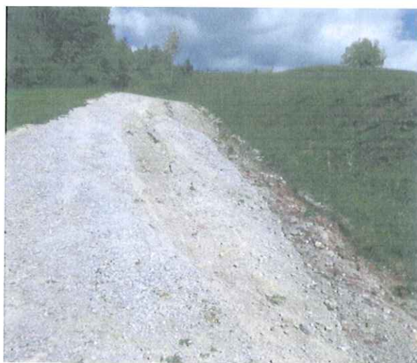
Poškodovana javna pot JP 708922 - Ježni Vrh – Puščar - Preska v Ježnem Vrh
