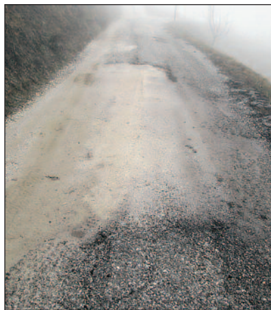
Poškodovana cesta proti Tisju.
